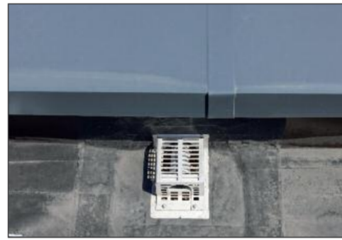
Auf dem nicht einsehbaren Flachdach geht es um (Abfluss-)Leistung. Durch die Wahl der Loro-Duoflux-Attika-Direktabläufe genügen zwei Ablaufpunkte, um die gesamte Fläche sicher zu entwässern.
